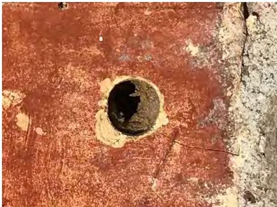
Abb. 4: Offensichtlich als Hymenopteren-Brutzelle genutztes altes Dübel-Bohrloch in einem Ziegelstein der Hauswand.
