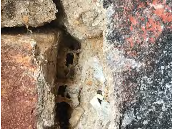
Abb. 3: Reste von Hymenopteren-Brutzellen in einem Mauerspalt der Hauswand.
